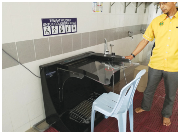
Tempat wuduk SAHALA
